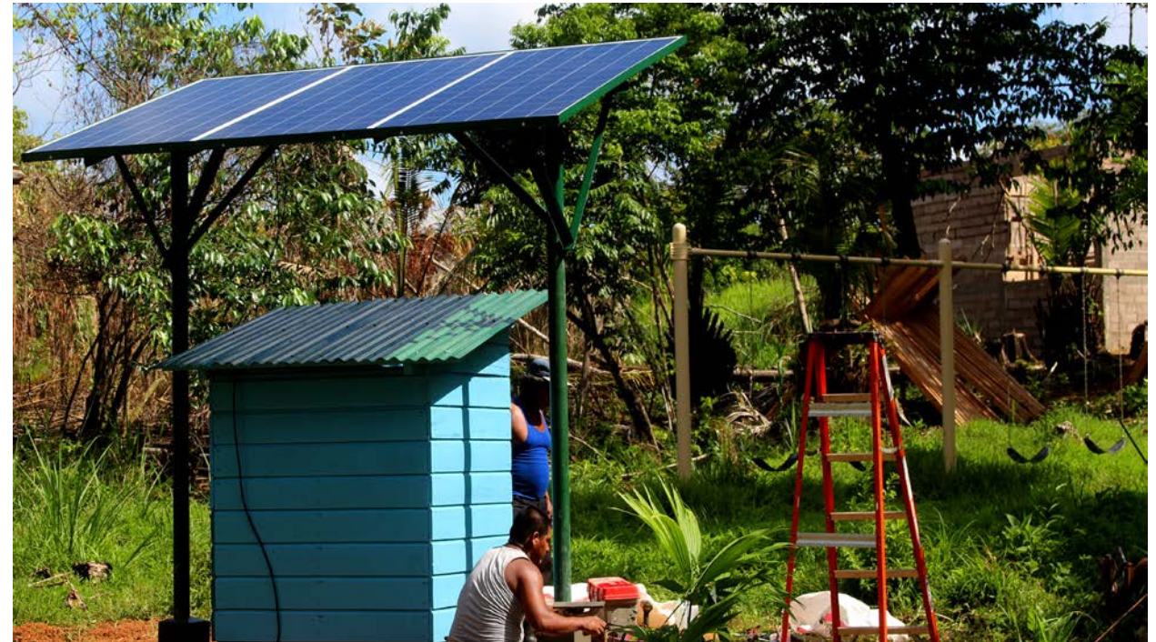
Instalación del local técnico del sistema de bombeo de agua solar en la comunidad Rama Maneland/Rama Cay, Bluefields, Nicaragua.
